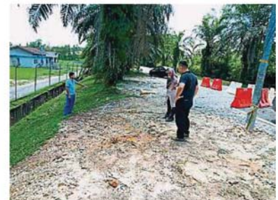
由于路边的输水管破裂, 公主鎮布特丽3路在封路逾4个月仍未能全面开通。
